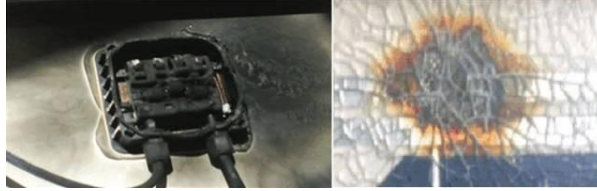
图1 接线盒烧毁引发背板烧焦从而导致组件破碎
