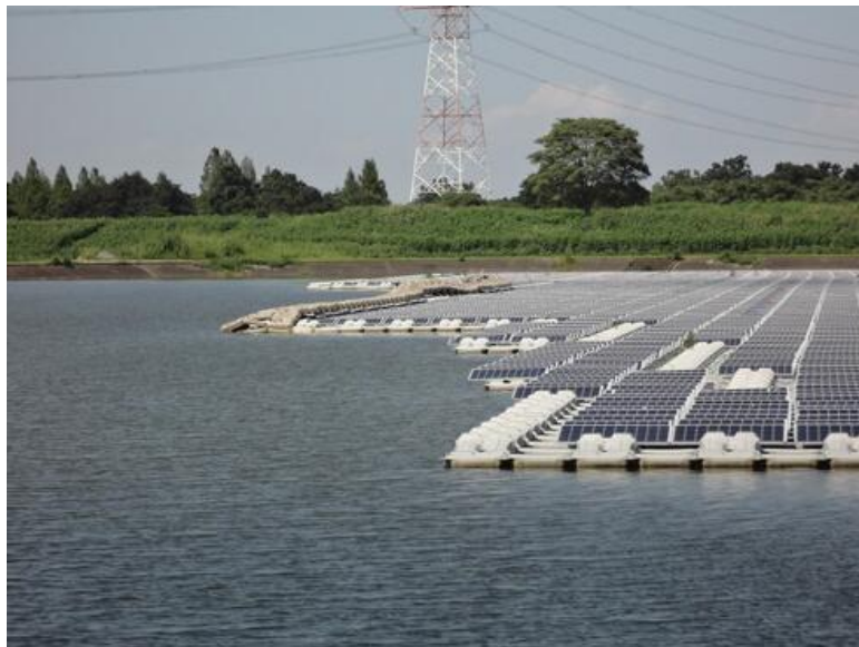
超出浮体架台边缘部分的电池板翻倒
