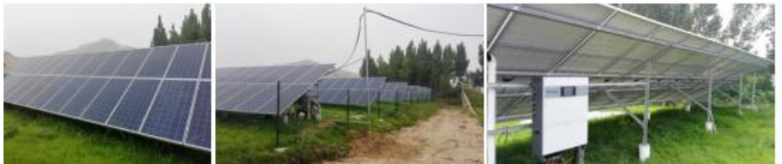
山东村级电站项目
